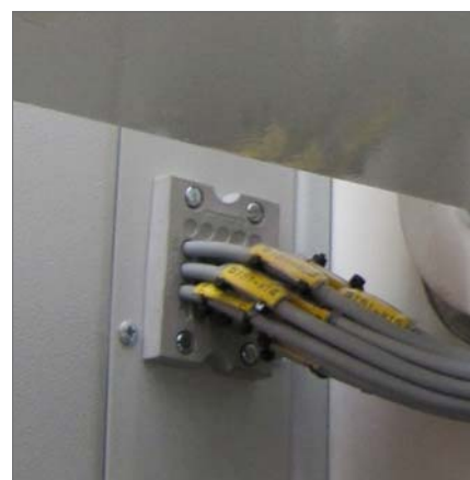
KEL-DPZ B25 - Página 64 Entrada de cables con IP66 en un espacio reducido.
