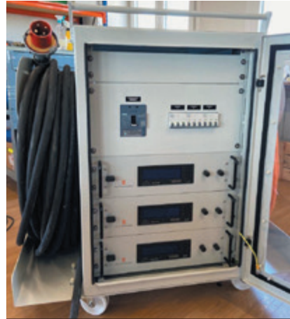
Sistema de carga de baterías
