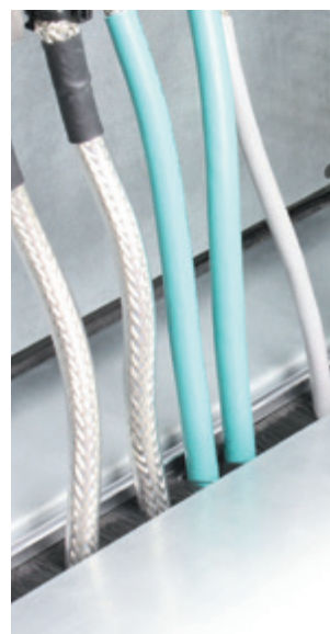
KDR-BES-U en armario eléctrico
